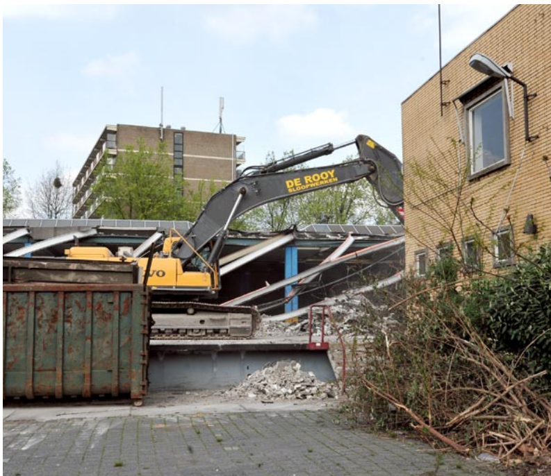
Mei 2013, sloop van de gebouwen op het Van Gend en Loos-terrein foto: John Geerts
